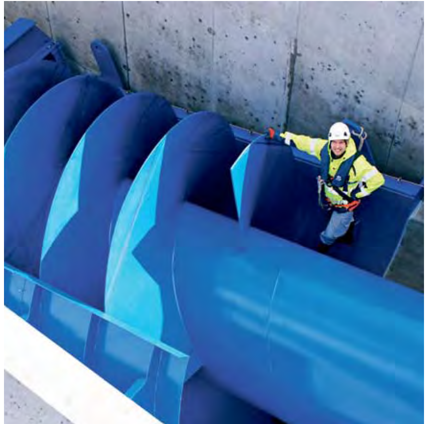
Die Wasserkraftschnecke der ebswien hauptkläranlage: 13 Meter lang, 26 Tonnen schwer
